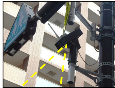
警告表示板のセンサー（東京都内）
